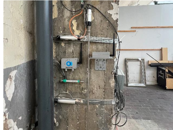
Abbildung 2: Installation eines Crack- und Tiltmeters.
