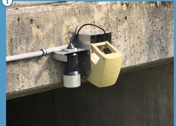
Radarsensoren zur Bestimmung des Wasserstandes und der Fließgeschwindigkeit an kritischen Stellen im Gewässerlauf
